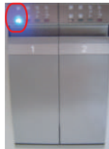
③解錠ランプ点滅のボックスの扉を手間引いて開ける
